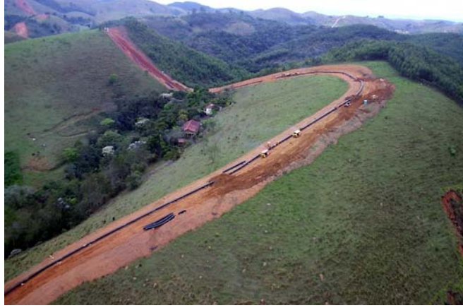
Şekil 1.11. Doğalgaz iletim hattı
