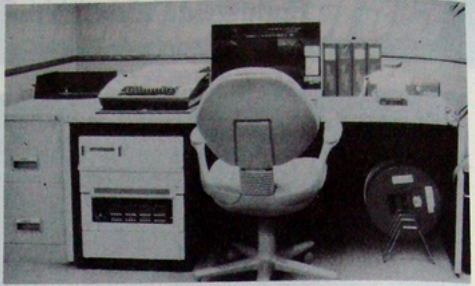
(Fotoğraf: 2) Ampex'in enerji yönetim sisteminin ana santrali ana yönetim binasında cam ile çevrili bir odada bulunmaktadır. Ana işlem birimi (CPU), masanın sol alt bölümünde yer almaktadır. Yazıcı tuş takımı ve renkli bir ekran ve onun tuş takımı ile kullanıcı enerji yönetim sistemi ile bağlantı kurar. Binalar arası haberleşme telefon ile yapılmaktadır. Modem ise, yetkiliye, sistemi, evinden izleme olanağı verir.
