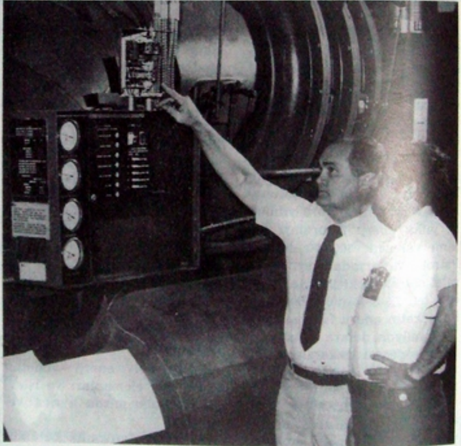
(Fotoğraf: 3) Fabrika bakım ve enerji yönetim müdürü Ben Schweickert ve teknisyen Kobad Jamshed enerji yönetim sistemindeki soğutucu bölümünü inceliyorlar. İki sistem arasındaki bağlantı kontrol panelinin üstünde bulunan alan işlem birimi ile yapılmaktadır. Enerji yönetim sisteminden gelen işaretlerle kontrol edilen röle kontakları, soğutucunun kontrol devresine bağlıdır.
