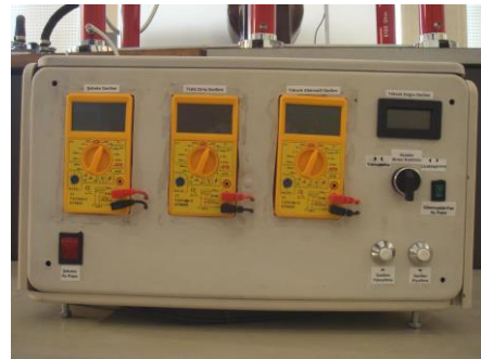
Şekil 9: Yapılan kontrol ve kumanda panosu.
