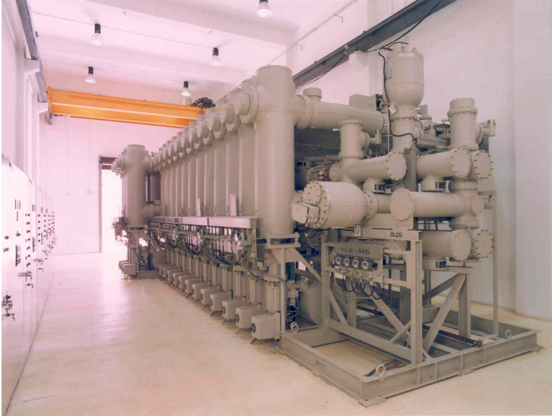
Soğanlık GIS Trafo Merkezi
