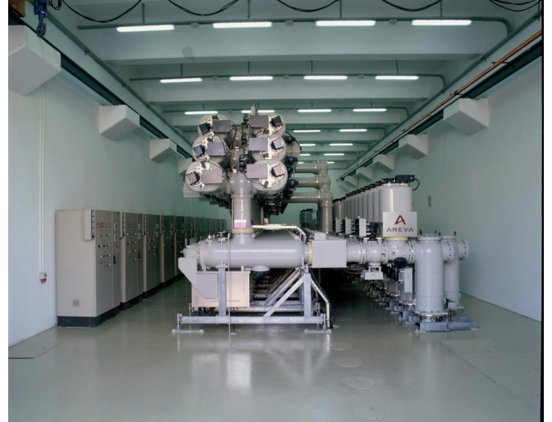
Ümraniye GIS Trafo Merkezi
