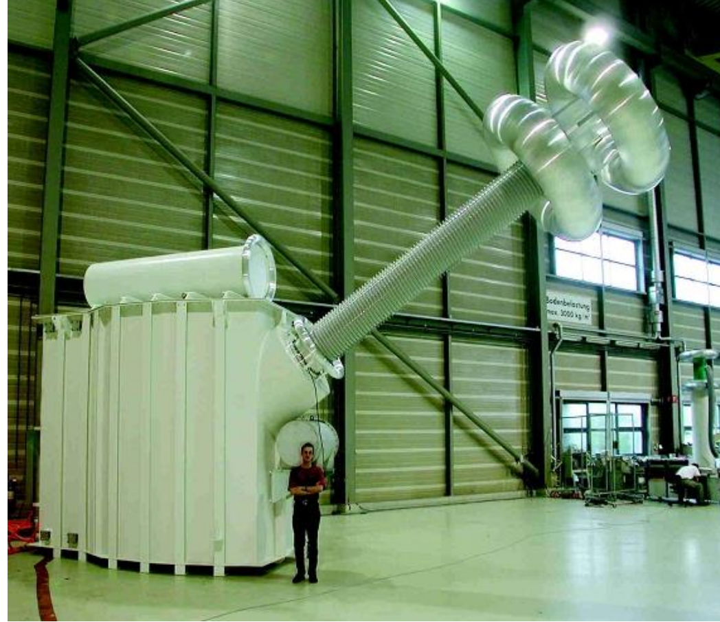
750 kV, 2100 kVA deney transformatörü
