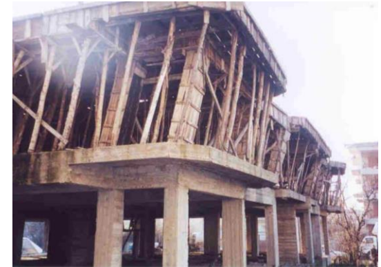
Yeterli çapraz eleman olmaması nedeniyle kalıp göçmesi
