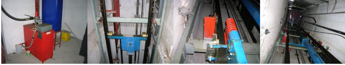
Şekil 4. Hidrolik asansörün deprem sonrası durumu
