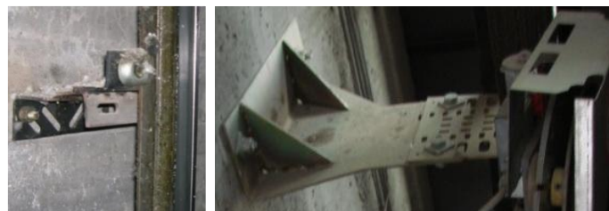
Şekil 2. Konsol eğilmesi, hasara uğraması (İmrak, 2012).
