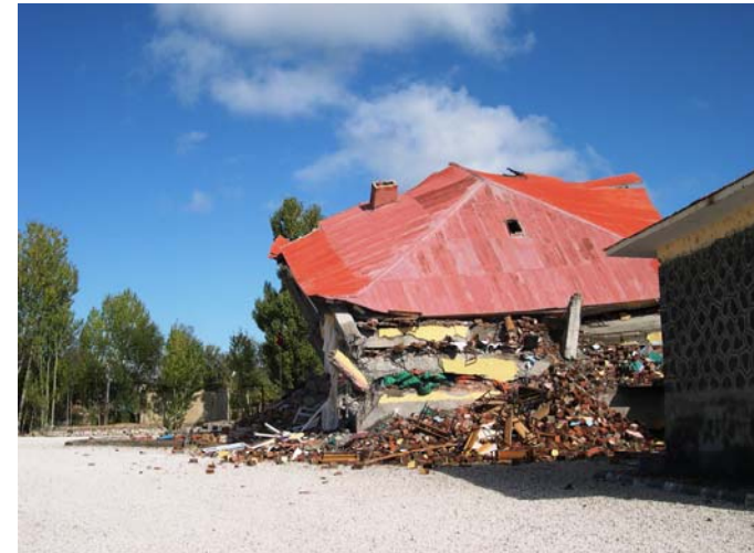
• Yapısal hasar: Göçme (Gedikbulak İlköğretim Okulu Binası)
