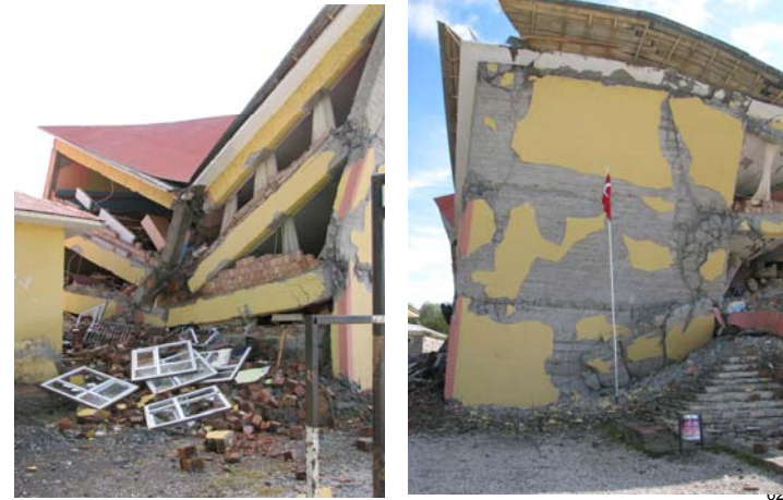
Yapısal hasar: Göçme (Gedikbulak İlköğretim Okulu Binası)
