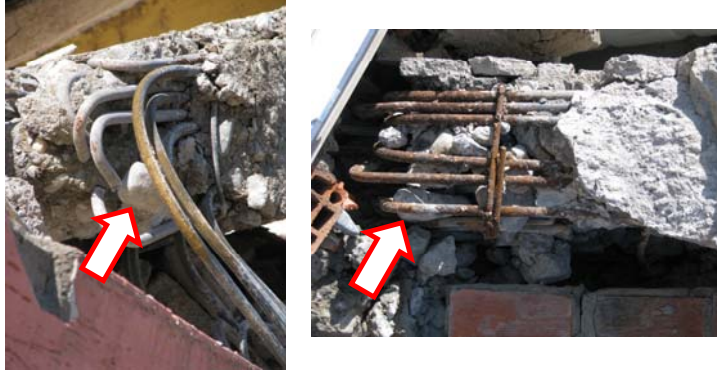
Yapısal hasar: Göçme – Uygun olmayan büyüklükte agregalar (Gedikbulak İlköğretim Okulu Binası)
