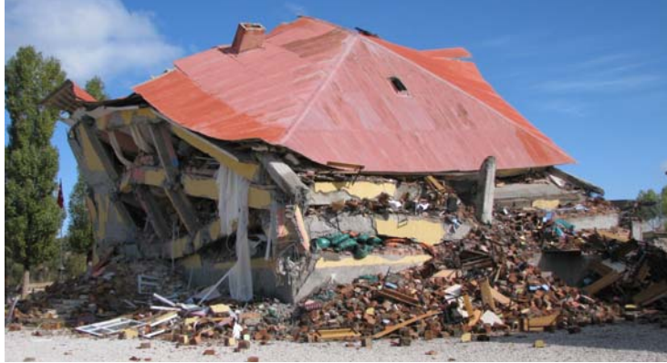
Yapısal hasar: Göçme (Gedikbulak İlköğretim Okulu Binası)
